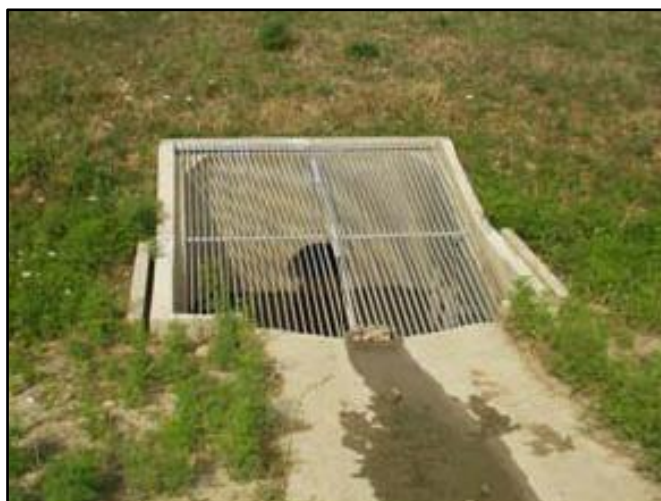
Figure 4 : Grille de protection sur ouvrage de sortie
